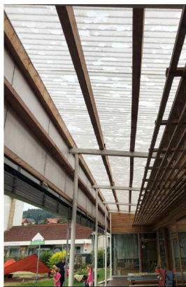
Zerstörte Wellplatten beim Kindergarten
